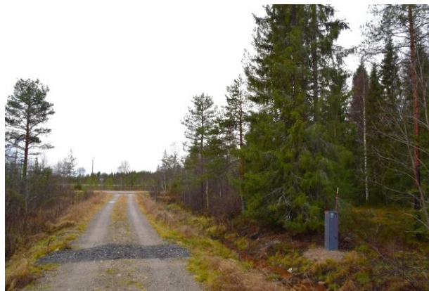
Kuva. Näkymä vastakkaiseen suuntaan laajentumisalueen Naamankaojan ylittävältä katurummulta kohti Syötesuontietä. Caruna Oy on tehnyt alueella ilmajohtojen siirtoja maakaapeleiksi. Kuvassa on peitelty maakavanto ja uusi sähkönjakokaappi.
